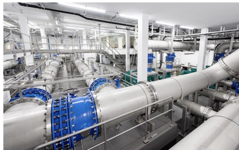
Im Innenbereich der Pumpstation Lange Erlen
