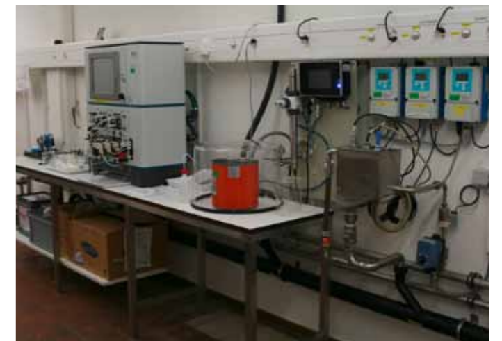
Abb. 5: Messraum mit der Online-Rohwasseranalytik.
