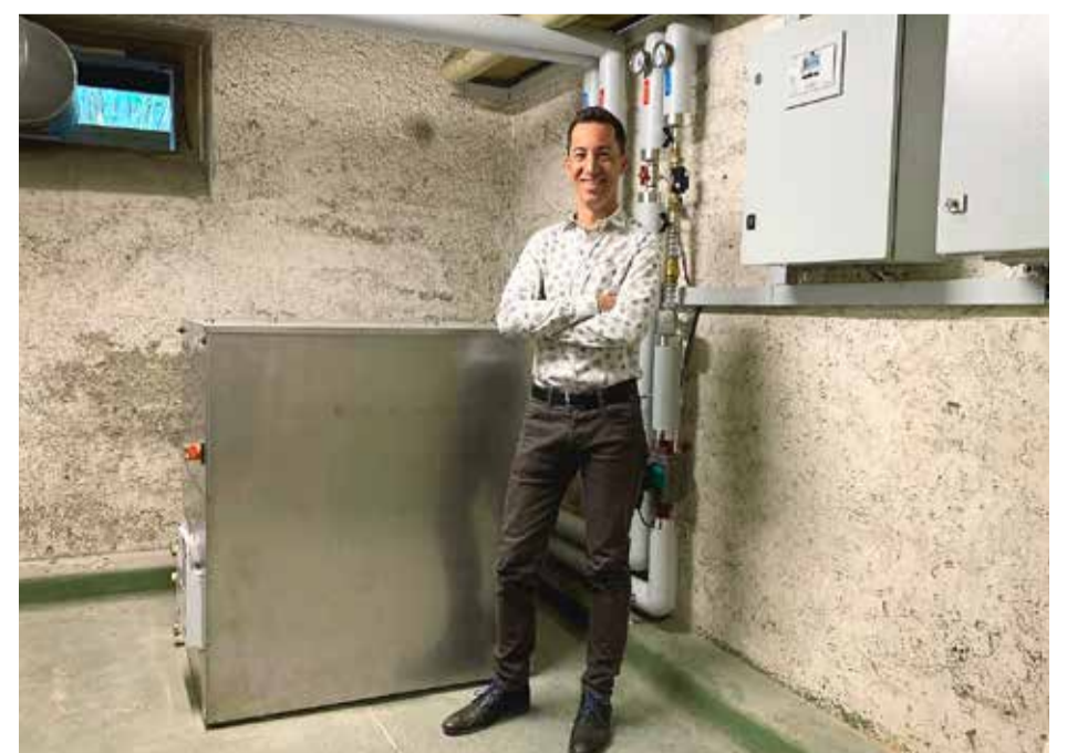
Projektleiter Stephan Février erhält viele Anfragen zum Heizkonzept.
