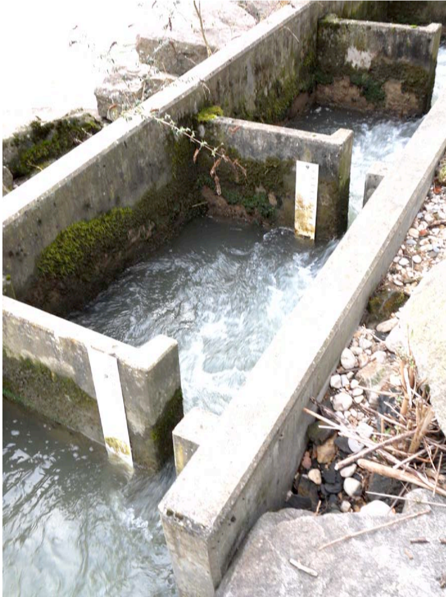
Fischtreppe Kraftwerk Neuwelt mit neu installierten Messlatten
